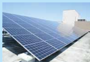
当院病棟屋上に設置されているソーラーパネル
